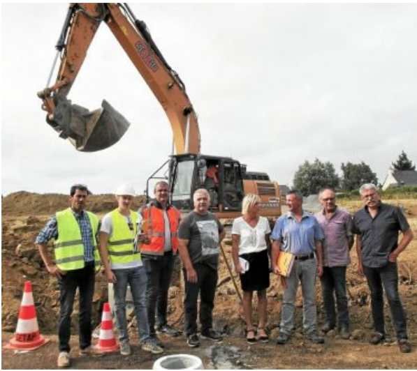
Les acteurs d'entreprises avec la commission communale travaux et le maire, Dominique Tierel, à droite, lors de la réunion de chantier.
